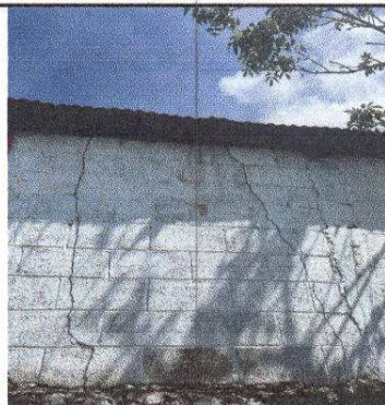
Foto 2: Pared del baño blok rajado
