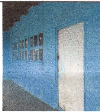
Foto 4: Pintura en mal estado
