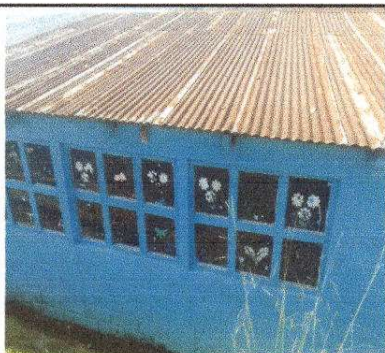
Foto 5: Techo en mal estado
